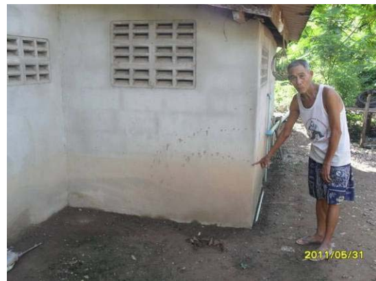
รูปที่ 3.24 บ้านเรือนบริเวณบ้านเค็ม ที่ได้รับความเสียหาย จากน้ำป่าไหลหลากเมื่อ ปี พ.ศ. 2549
