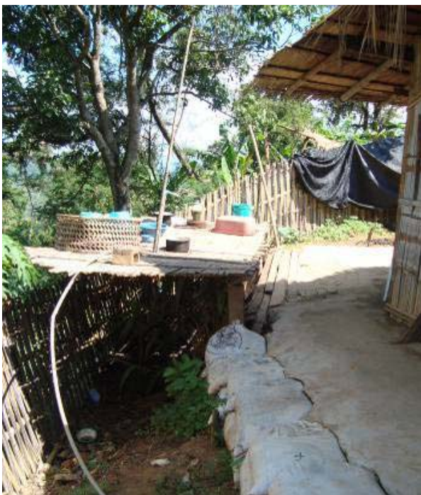
รูปที่ 3.3 ร่องรอยความเสียหายจากการตั้งบ้านเรือน อยู่บริเวณไหล่เขาที่มีความลาดชันสูง บ้านอาถู อําไฮ
