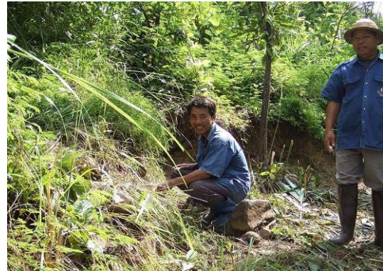
บริเวณที่เกิดรอยแยก มีการทรุดตัวลง 1 เมตร
