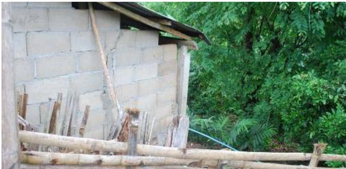
รูปที่ 3.17 ร่องรอยความเสียหายจากการตั้งบ้านเรือนอยู่บริเวณไหล่เขาที่มีความลาดชันสูง บ้านสี่หลัง
