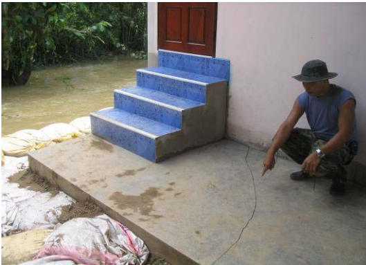
รอยร้าวบนพื้นบ้าน
