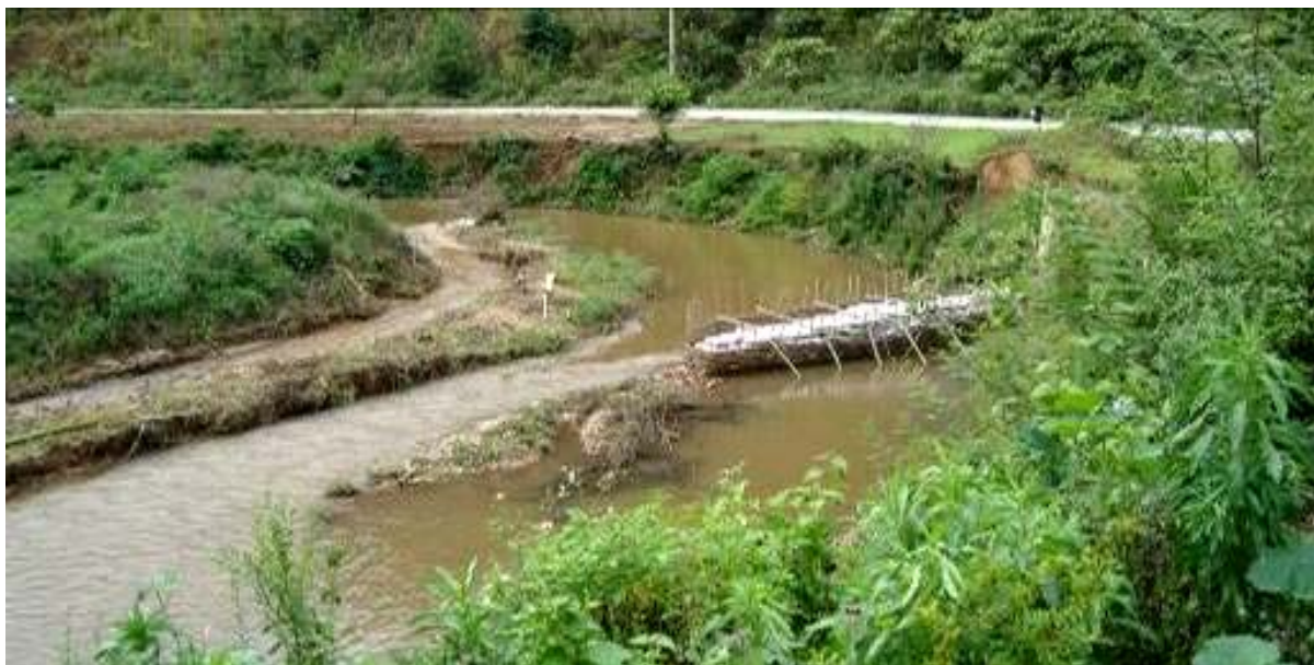
รูปที่ 3.28 ร่องรอยตลิ่งพังบริเวณโค้งน้ำ บ้านเล่าลือ
