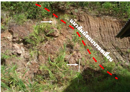
หมุดสำรวจ (ลูกครสีขาว) การตรวจสอบการเคลื่อนตัวของชั้นดิน
