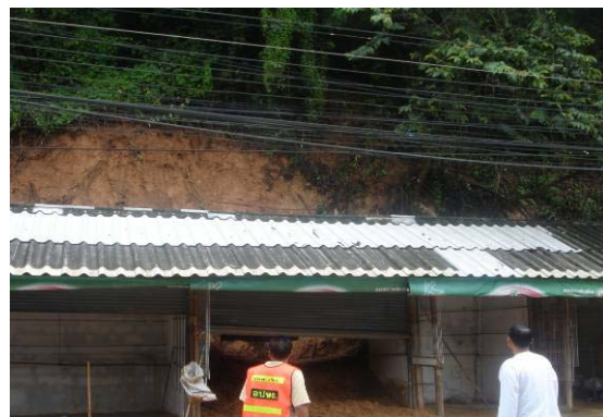
ดินบนยอดเขาบริเวณวัดพระธาตุปูเข้า ไหลลงมาปิดทับร้านค้า เนื่องจากฝนตกหนักมากกว่า 180 มม. ต่อวัน
