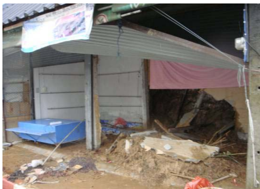
ความเสียหายจากดินไหลปิดทับร้านค้า บริเวณสามเหลี่ยมทองคำ
