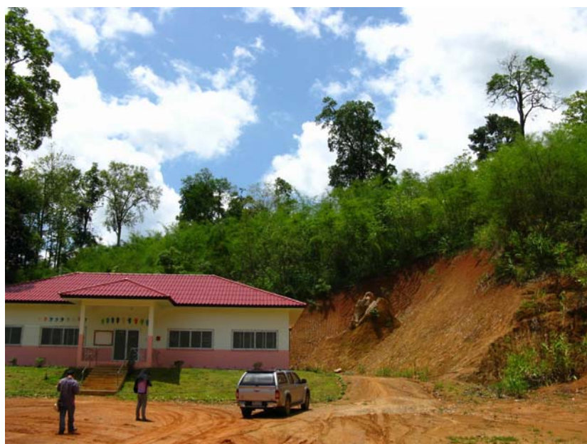
รูปที่ 3.11 การตัดไหล่เขาสร้างอาคารศูนย์อนุบาลเด็กเล็กบ้านสบป่อง ทำให้มีโอกาสเกิดดินไหลทับอาคารเสียหายได้
