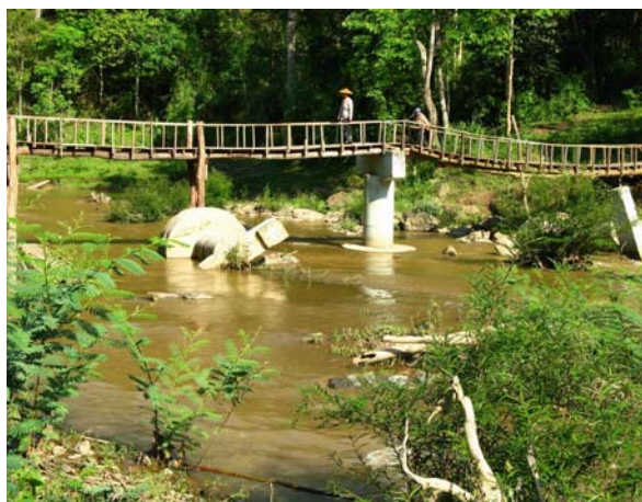
รูปที่ 3.24 ความเสียหายของตอม่อสะพาน จากน้ำป่าไหลหลาก ใกล้บริเวณถ้ำ น้ำลอด
