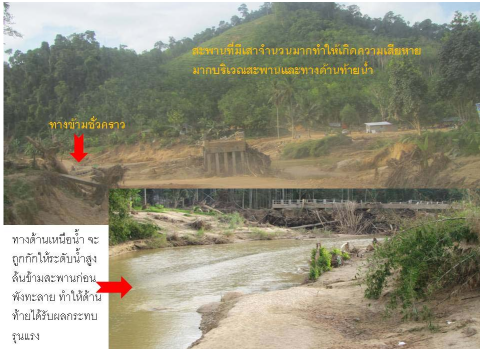
รูปที่ 5.3 สะพานข้ามลำน้ำซึ่งมีเสาสะพานจำนวนมาก กลายเป็นเขื่อนขนาดย่อมกีดขวางการไหลของเศษซากไม้และตะกอนดิน เมื่อไม่สามารถต้านทานไหวจึงพังทลาย
