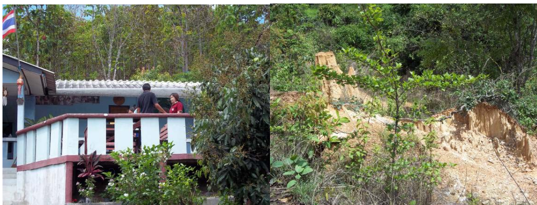
รูปที่ 3.2 รูปบ้านเรือนตั้งอยู่หน้าเขา เสี่ยงต่อดินถล่ม
