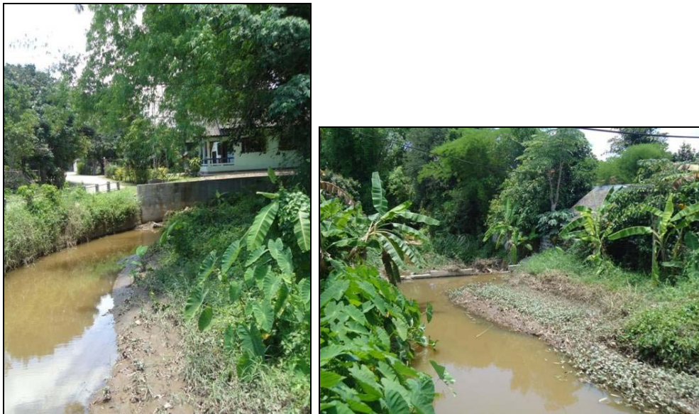
รูปที่ 3.1 รูปบ้านเรือนตั้งอยู่ใกล้ทางน้ำ เสี่ยงต่อการถูกกัดเซาะก่อความเสียหายแก่บ้านเรือน
