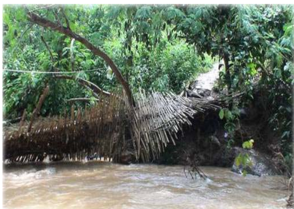
รูปที่ 2.7 สะพานข้ามลำห้วยสะเนียง หลังเกิดเหตุ น้ำป่าไหลหลาก
