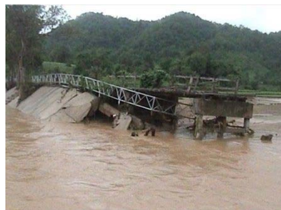
รูปที่ 2.10 ความเสียหายจากเหตุน้ำป่าไหลหลาก ในพื้นที่ จังหวัดน่าน
