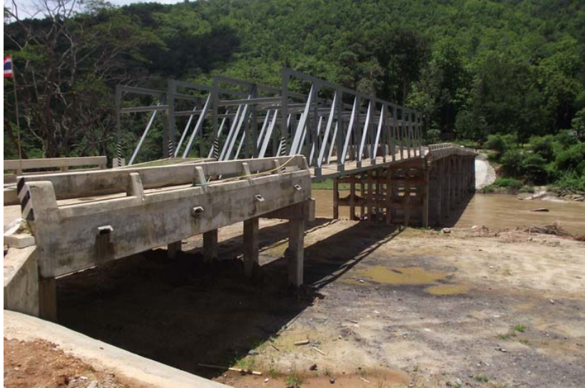
รูปที่ 3.3 สะพานข้ามห้วยแม่ตื่นบริเวณบ้านโบเก้ที่ชำรุดเสียหายจากน้ำป่าไหลหลาก
