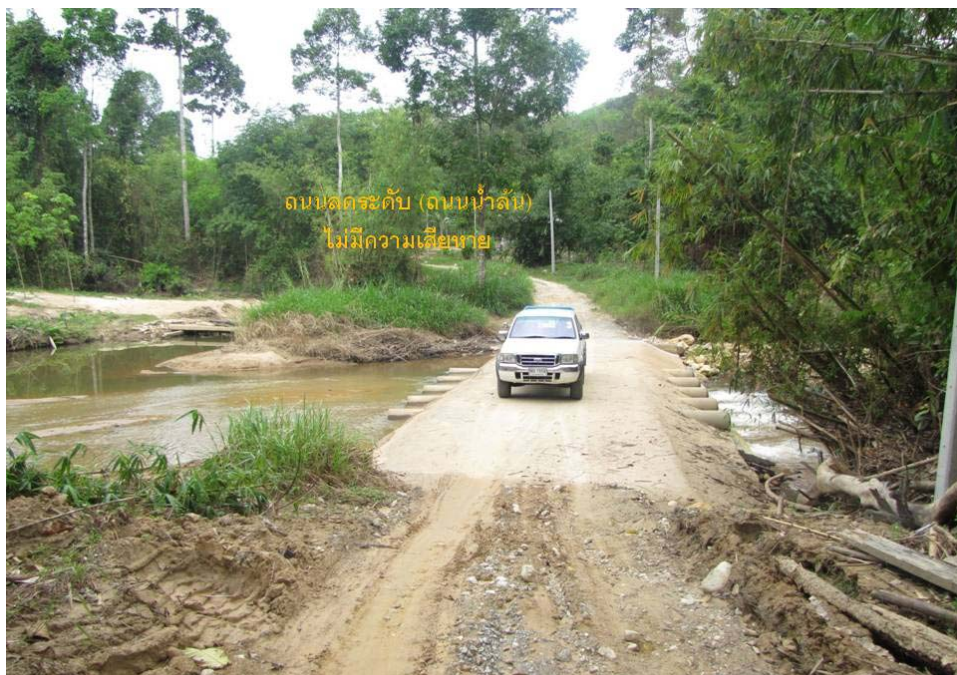
รูปที่ 5.4 ถนนแบบลดระดับ (ถนนน้ำล้น) ซึ่งเหมาะสมกับพื้นที่ทางน้ำขนาดเล็ก
